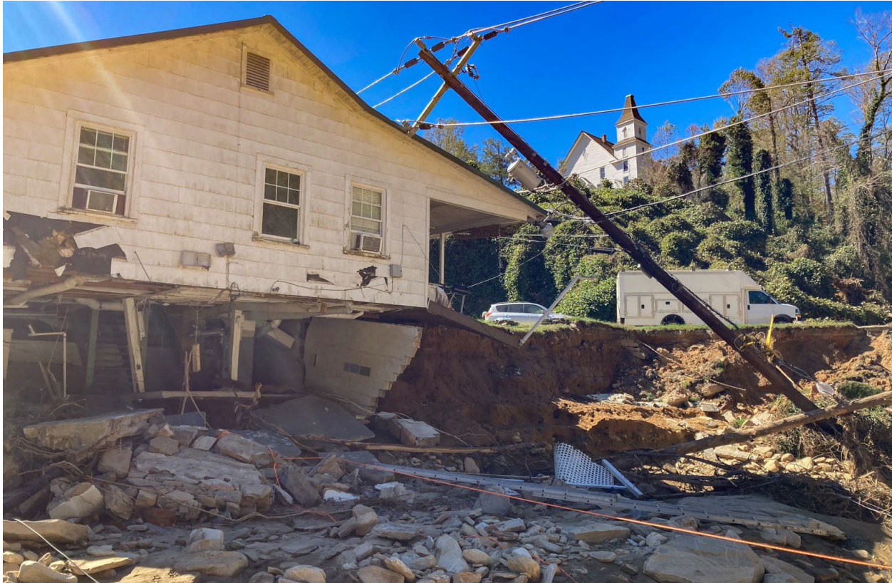
Figura 6: Daños en los cimientos de una vivienda, US Route 64, Bat Cave, NC. 10 de octubre de 2025.
